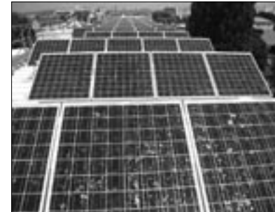
Abbildung 4-9: Photovoltaik-Elemente auf dem Dach © Architekturbüro Reinberg
