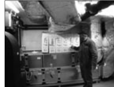
Abbildung 4-3: Lüftungszentrale © Architekturbüro Reinberg
