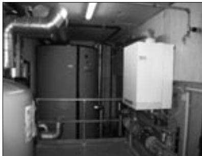
Abbildung 4-8: Technikraum mit Speicher und Gasbrennwertkessel © Architekturbüro Reinberg
