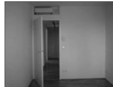
Abbildung 4-7: Heizkörper über den Türen © Architekturbüro Reinberg
