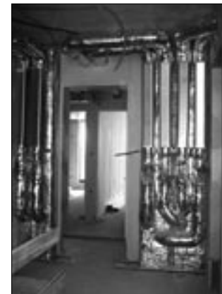
Abbildung 4-4: Lüftungsleitungen im Stiegenhaus © Architekturbüro Reinberg
